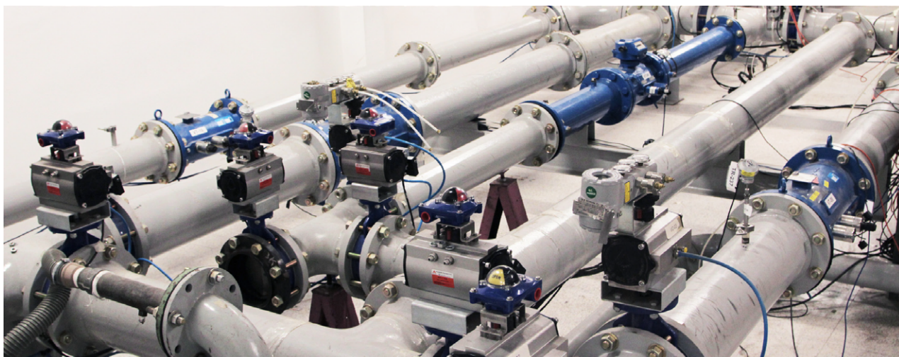
Figura 1 – Bancada do laboratório de vazão de gás da TRM/IPT para calibração de medidores com diâmetro nominal de 1 ½” até 12”.
