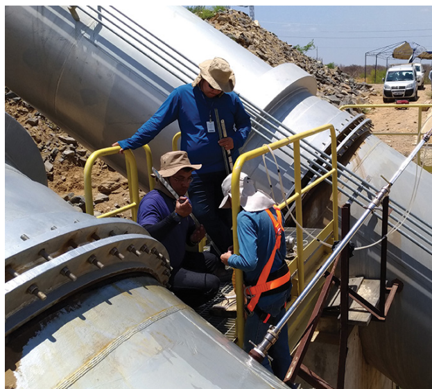
Figura 3.5.34. Imagem de Medição de vazão de água em estação de bombeamento do Projeto de Integração do São Francisco-PISF.
