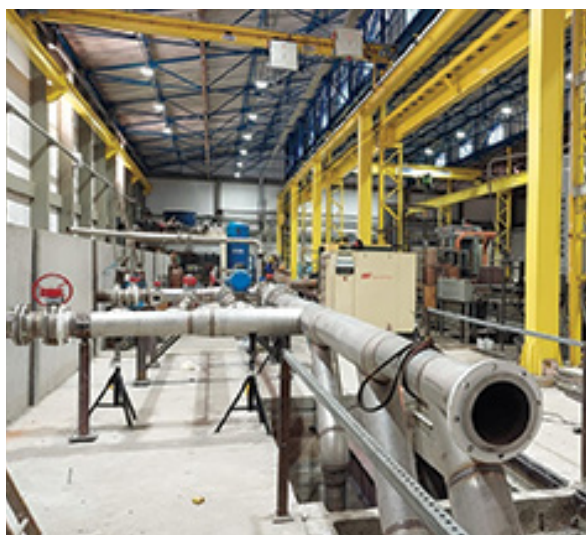
Figura 3.5.35. Imagem do Laboratório de ensaios de desempenho de válvulas e acessórios de tubulação (Acervo LV, 2023).
