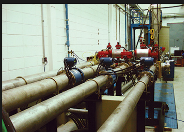
Figura 3.5.29. Imagem do Laboratório de vazão de água.
