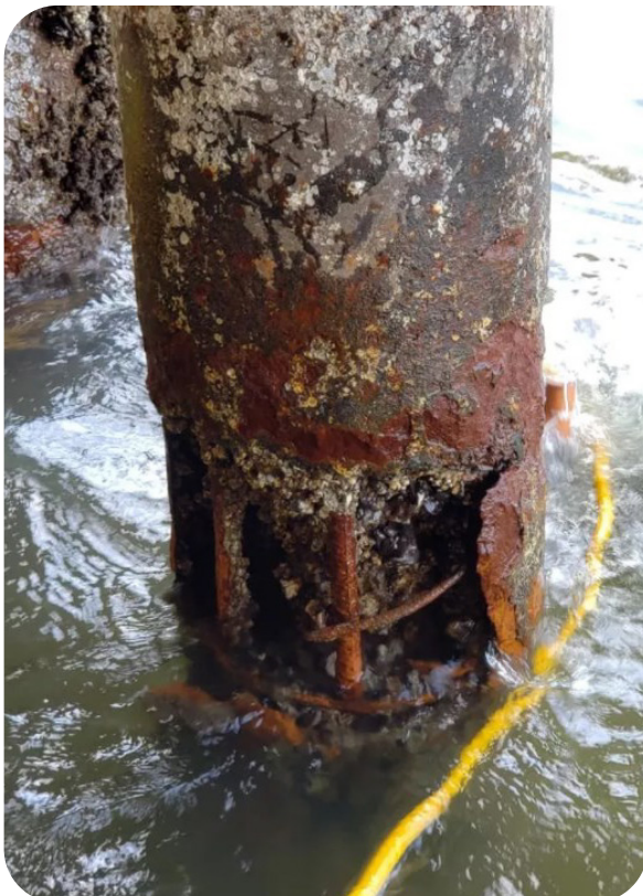
Figura 161 – Armaduras expostas e redução da seção transversal da estaca.
