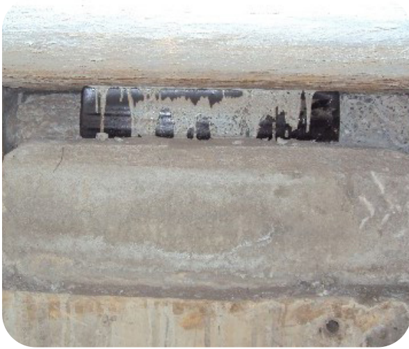
Figura 101 – Aparelho de apoio de elastômero impedido de se movimentar, devido a presença de concreto no seu entorno.
