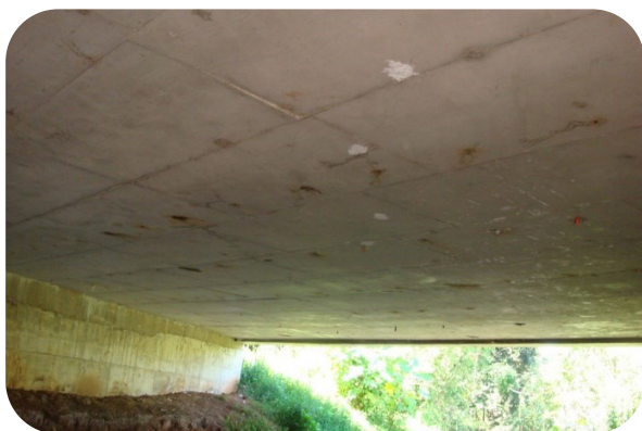
Figura 148 – Fissuras de flexão no vão central da laje.
