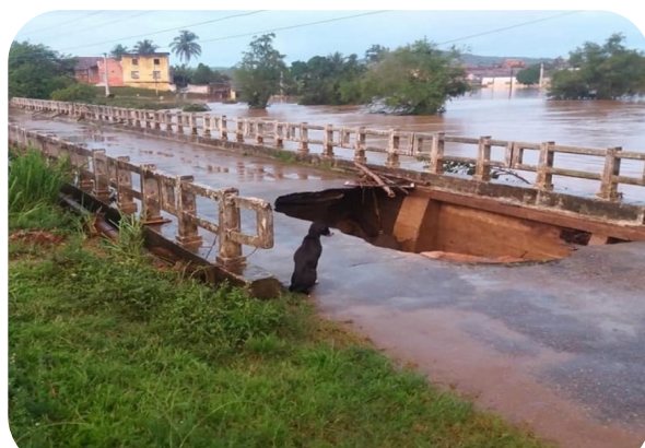
Figura 79 – Ruptura de encontro de ponte em Sergipe em 2019.
