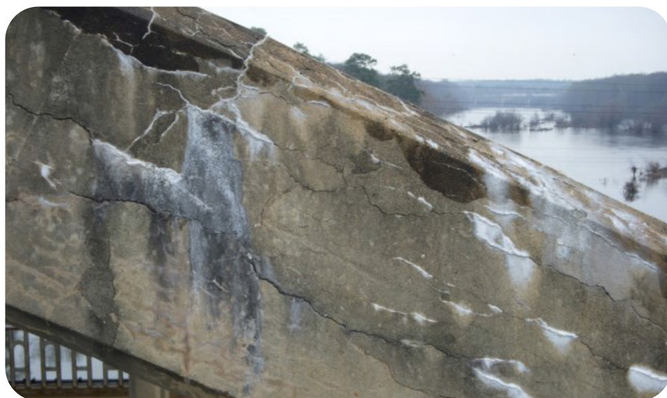
Figura 134 – Detalhamento de fissuração ocorrida devido à reação álcali-silica no vão 5 da The Bibb Graves Bridge.
