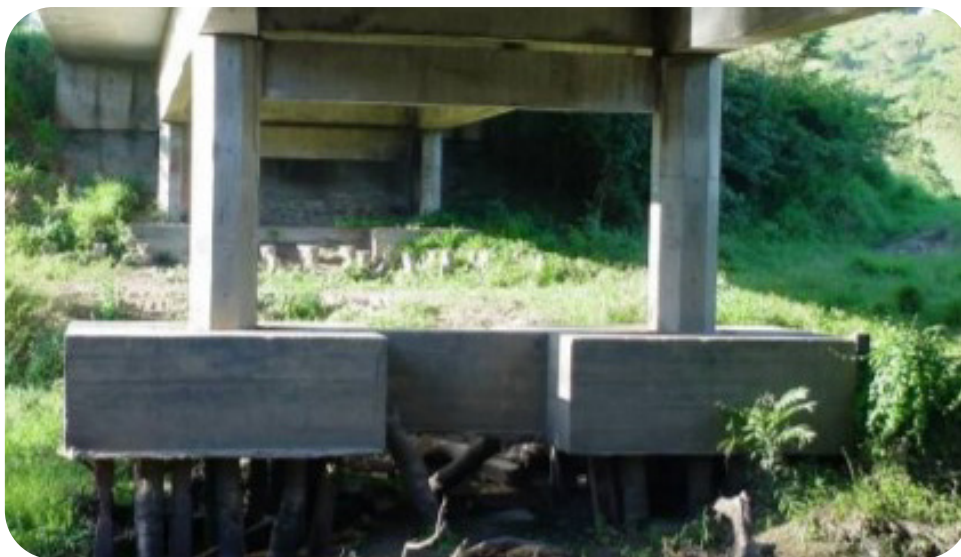
Figura 163 – Outro caso de exposição dos elementos de fundação por carreamento de solo pelas águas, erodindo a margem.
