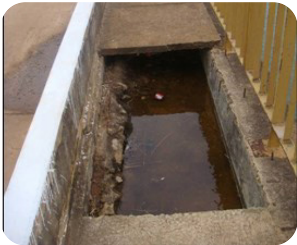
Figura 124 – Acúmulo de água na região dos passeios.
