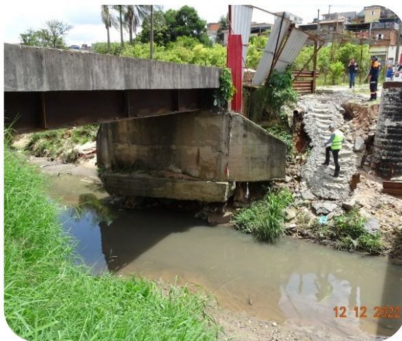
Figura 83 – Sulco junto ao muro de ala de uma ponte no interior do Estado de São Paulo.
