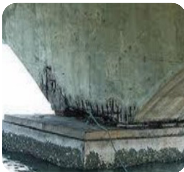
Figura 157 – Patologias no concreto na região de contato com o bloco de fundação (Bastos e Miranda, 2017).
