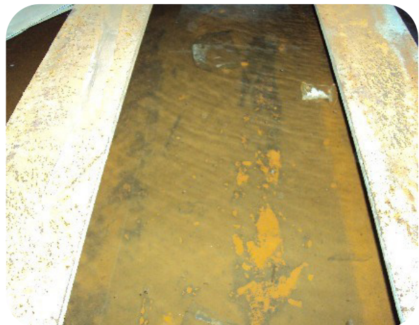
Figura 127 – Acúmulo de água no interior de caixão de ponte.
