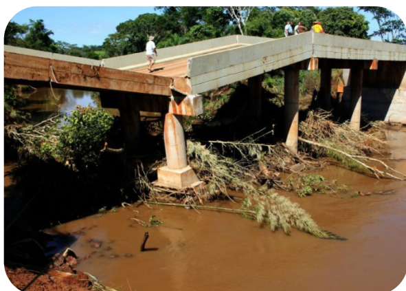
Figura 78 – Ruptura de apoios em ponte no Mato Grosso do Sul em 2018.
