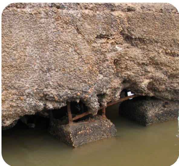
Figura 156 – Problemas na ligação entre as estacas de fundação e o bloco (Milititsky et al., 2008).
