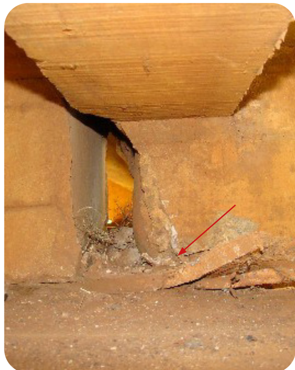
Figura 145 – Ruptura da região do canto da viga sobre aparelho de apoio deteriorado.
