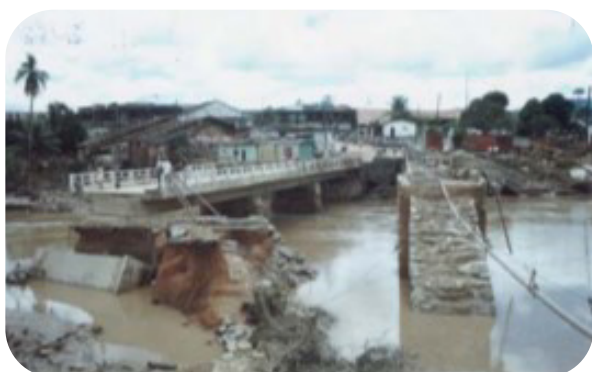
Figura 73 – Outro caso de destruição do aterro de acesso durante cheia no ano 2000.
