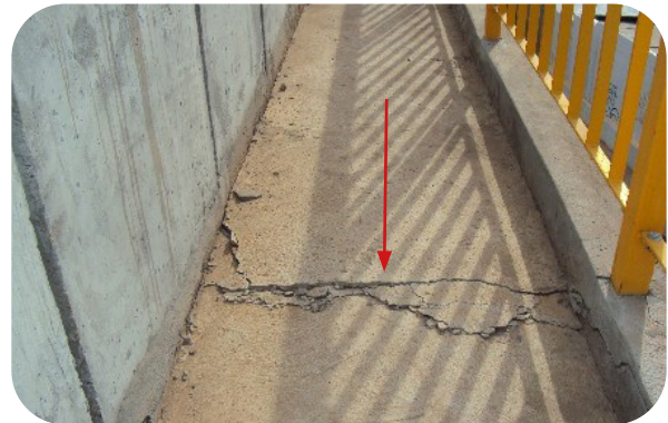
Figura 121 – Ausência da continuidade da junta de dilatação da pista de rolamento para a região do passeio da ponte, ocasionando trincas devido às movimentações da estrutura.
