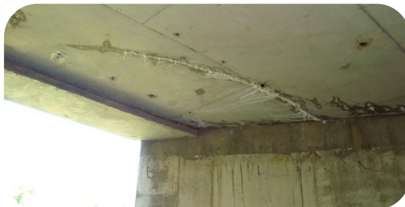
Figura 150 – Fissuras devido aos momentos volventes nos cantos da laje.
