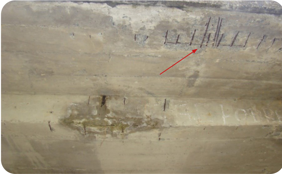
Figura 131 – Armaduras expostas (seta) na parte inferior do tabuleiro, decorrente de percolação de água devido a ausência de pingadeiras.
