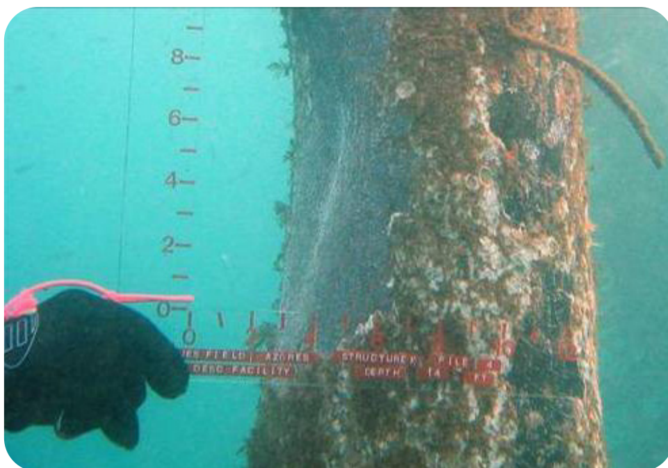
Figura 173 – Levantamento de informações de uma estaca durante a inspeção subaquática.
