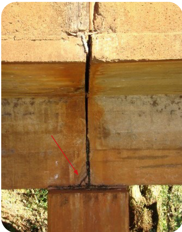
Figura 144 – Fissuras no canto da viga, na região sobre o aparelho de apoio.
