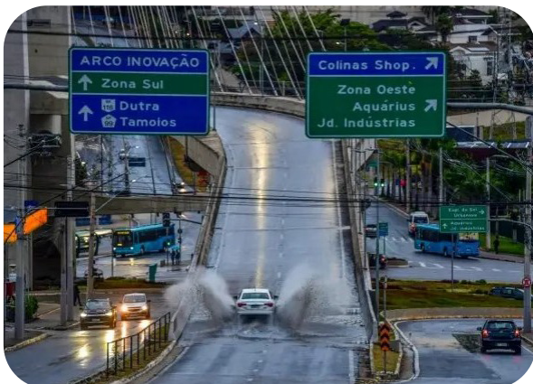
Figura 126 – Acúmulo de água sobre o tabuleiro devido à ausência de sistema de drenagem e escoamento adequado.
