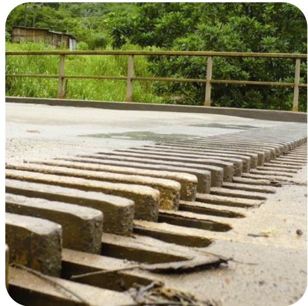
Figura 123 – Junta de dilatação dentada com desnivelamento, provocando risco elevado de acidentes de trânsito.
