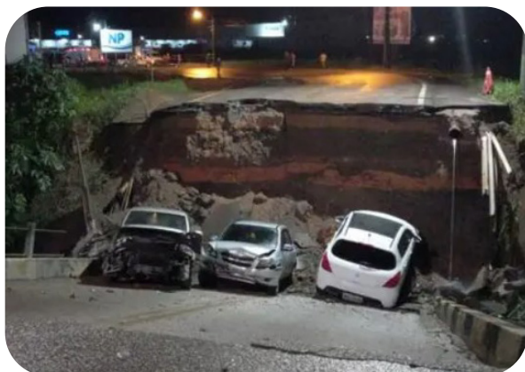
Figura 74 – Desabamento de cabeceira de ponte em Brusque, Santa Catarina, em abril/2021.
