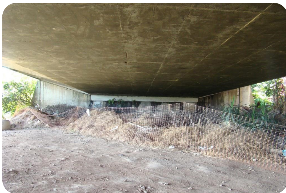
Figura 91 – Armazenamento de vegetação seca sob o viaduto.
