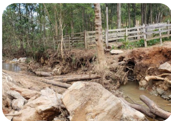
Figura 77 – Desabamento de ponte em estrada rural em Minas Gerais.
