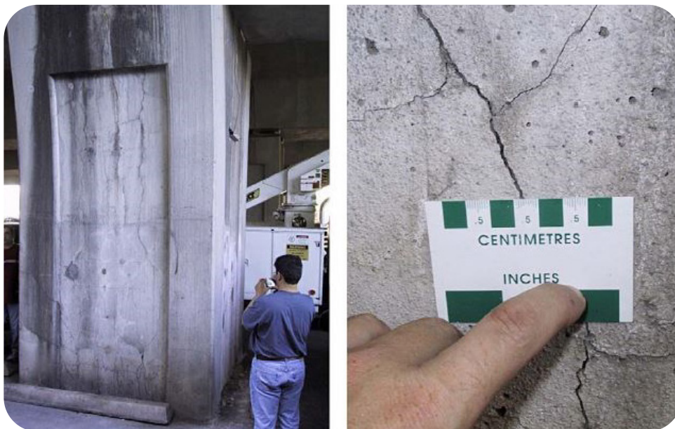
Figura 82 – (a) Inspeção de pilar deteriorado por ação de etringita tardia em estrutura de viaduto e (b) detalhe da configuração e dimensão das fissuras.
