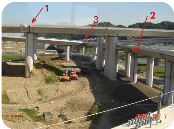
Figura 63 – Plataformas fixas para inspeção e manutenção de sistema viário no Japão. As setas indicam os locais onde estão instaladas as plataformas.
