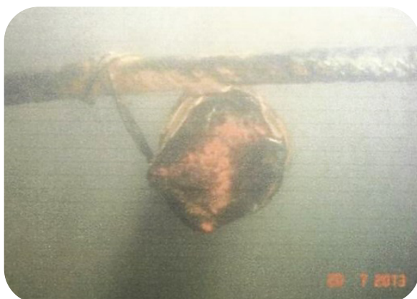
Figura 167 – Vista de barras de aço sem cobertura de concreto.
