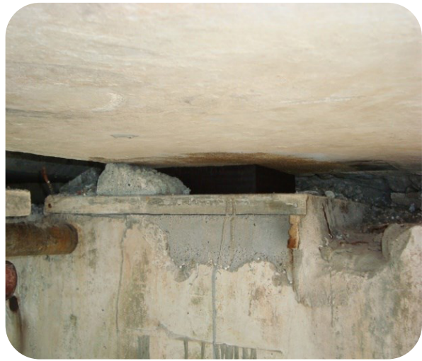
Figura 102 – Presença de detritos e concreto no entorno do aparelho de apoio de elastômero, impedindo o seu funcionamento adequado.
