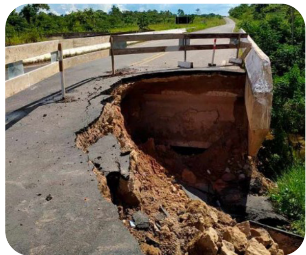
Figura 84 – Processo de ravinamento em encontro de ponte.
