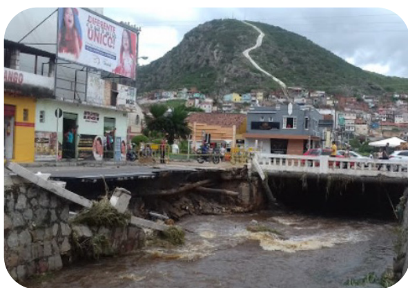
Figura 76 – Desabamento parcial de ponte no norte da Bahia no ano de 2019.
