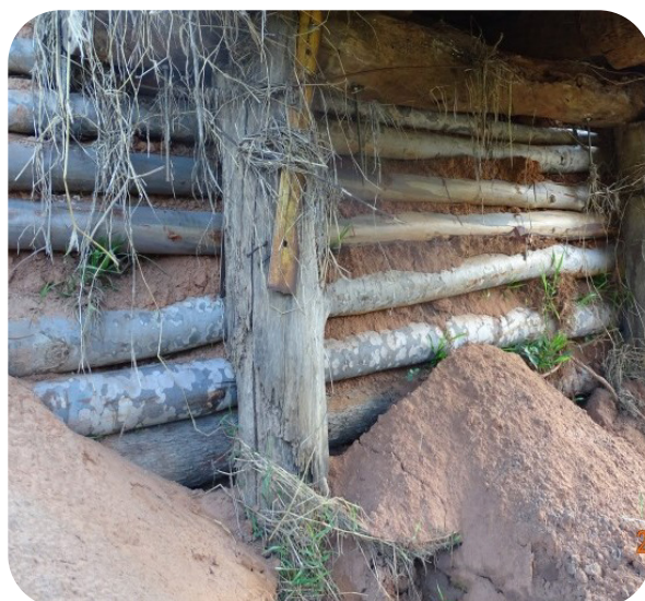
Figura 155 – Situação crítica de encontro de ponte no município de Presidente Bernardes, SP. Observar a ocorrência de carreamento de partículas sólidas do terreno.
