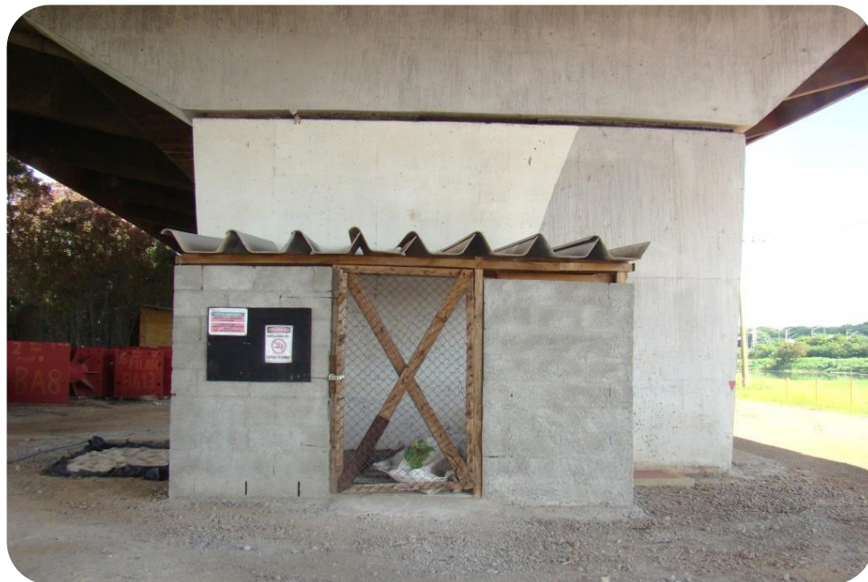
Figura 90 – Presença de depósito de material inflamável, localizado sob viaduto.
