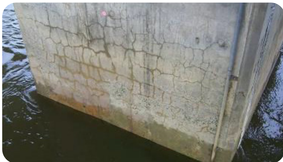
Figura 81 – Detalhe de pilar degradado pela ação de etringita tardia na The Bellevue Bridge, Reino Unido, em 2013.
