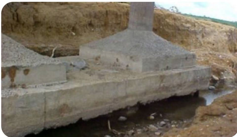
Figura 164 – Processos erosivos provocando o carreamento do solo sob o bloco de fundação.
