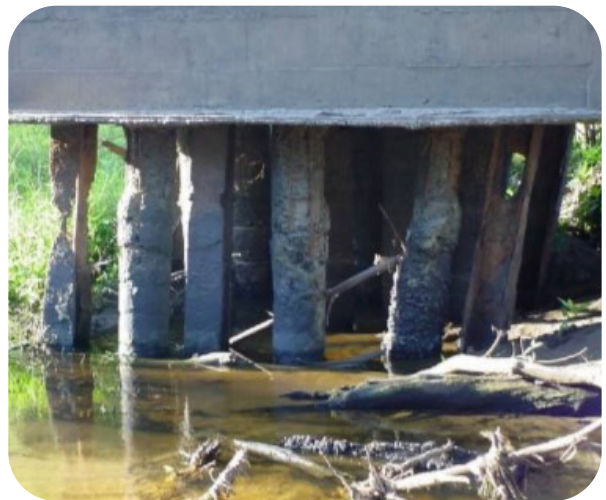
Figura 162 – Desconfinamento de trecho superior das estacas de fundação de uma ponte, expondo problemas de concretagem da fase de execução da obra.
