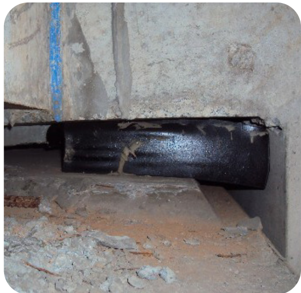
Figura 104 – Aparelho de apoio deslocado da posição de projeto, ocasionando concentração de carga somente de um lado.
