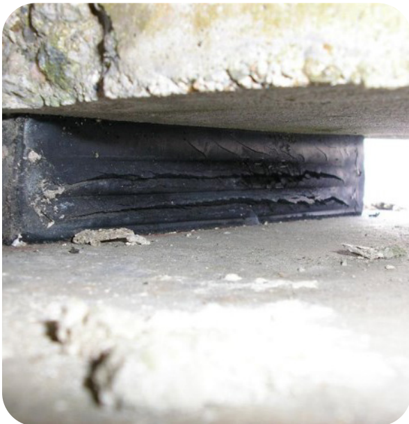
Figura 103 – Aparelho de apoio com elastômero danificado.
