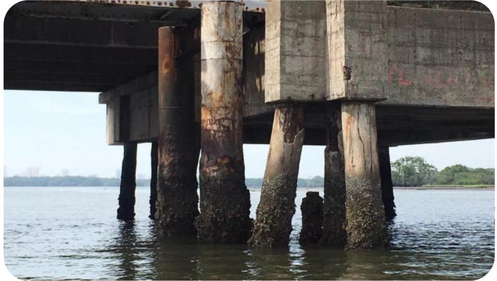
Figura 160 – Estacas de concreto deterioradas em ambiente agressivo.
