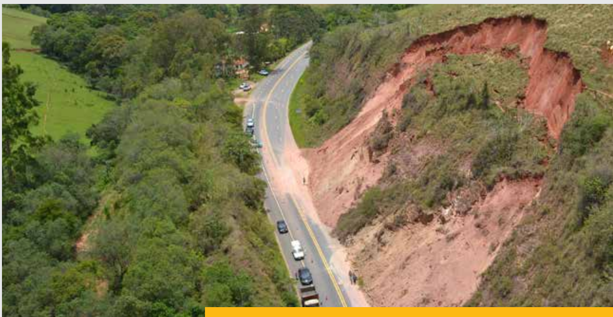
Deslizamento de terra em rodovia. Fonte: Arquivo IPT.
