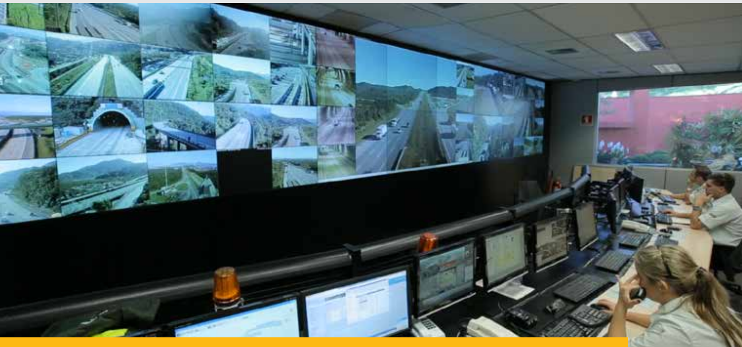
Cabine de controle da Ecovias para monitoramento de rodovias. Fonte: Arquivo IPT.
