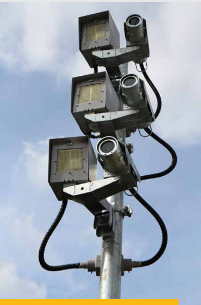
Radar implantado em rodovia do estado de São Paulo. Fonte: Arquivo IPT.
