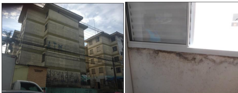
Figura 3: Edifícios habitacionais com problemas de umidade que afetam a habitabilidade e, consequentemente, a durabilidade (face externa e interna da parede de fachada).
