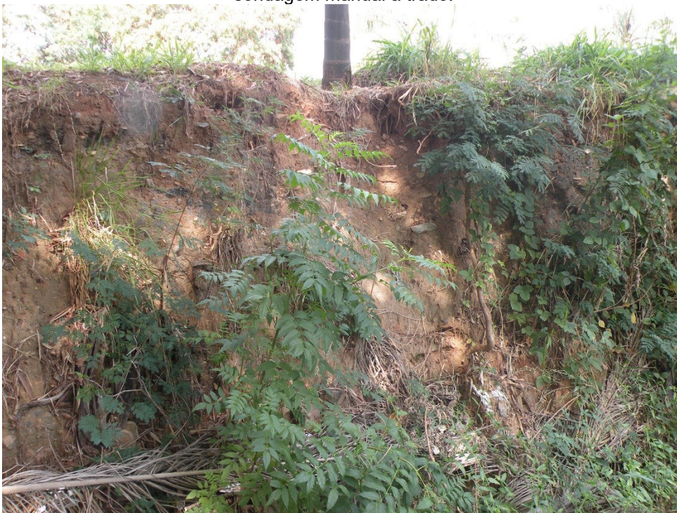
Figura 21 – Detalhe da Foto anterior, destacando a espessura do aterro, dificultando a sondagem manual a trado.
