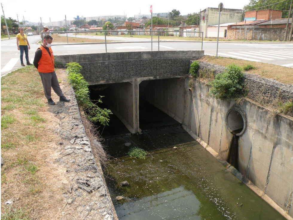
Figura 24 – Afluente do rio Capivari onde a planície aluvial foi urbanizada, com aterramento, canalização, arruamento e construção de casas, dificultando a delimitação e identificação pedológica. (Ponto CAp-03, Coord. UTM: 282.995/7.460.289)
