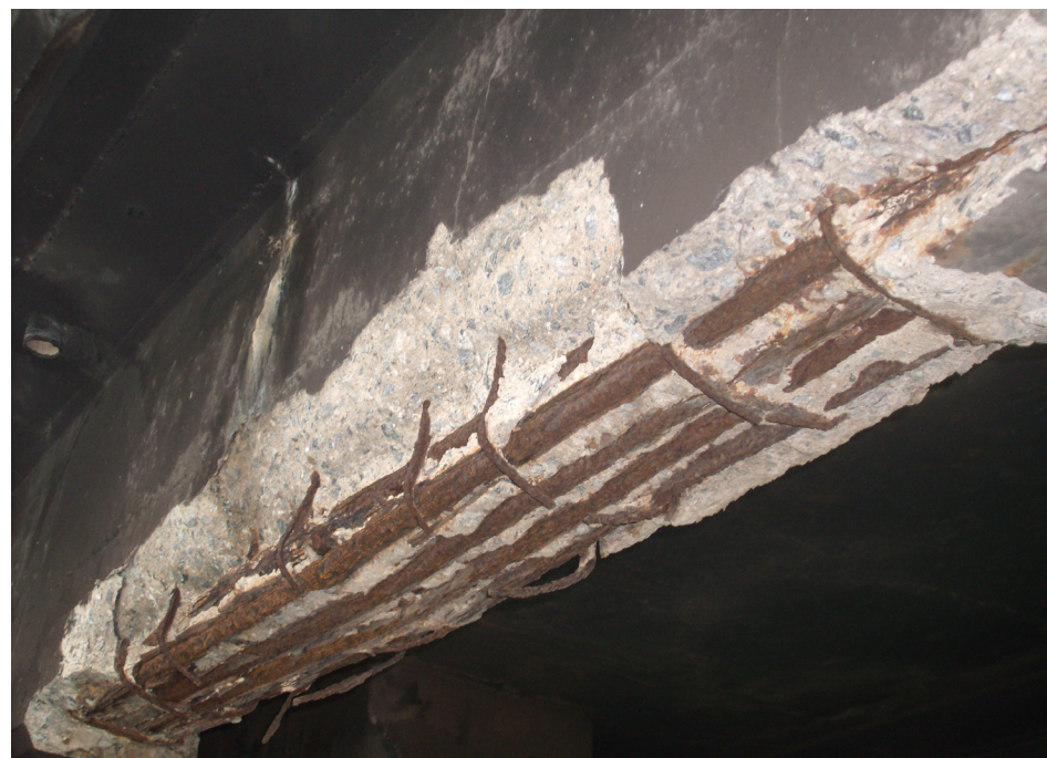
Corrosão intensa em viga de concreto armado
