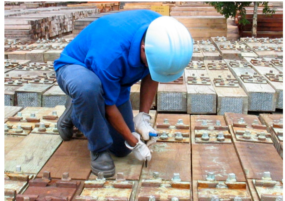
Inspeção em dormentes de madeira
