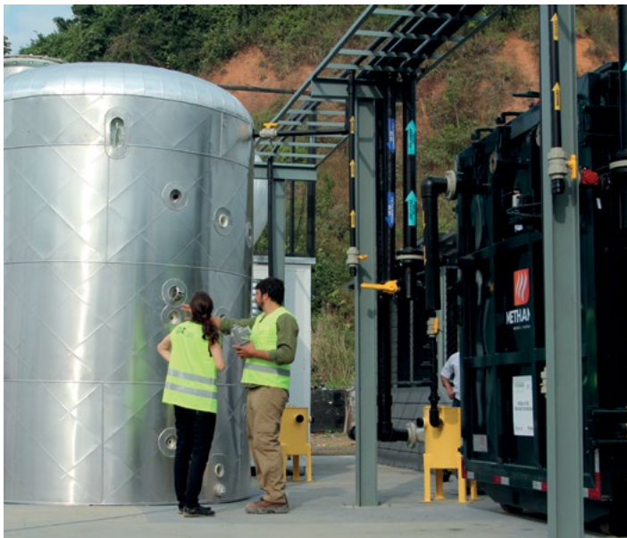
Planta de biodigestão em operação na cidade de Bertioga
